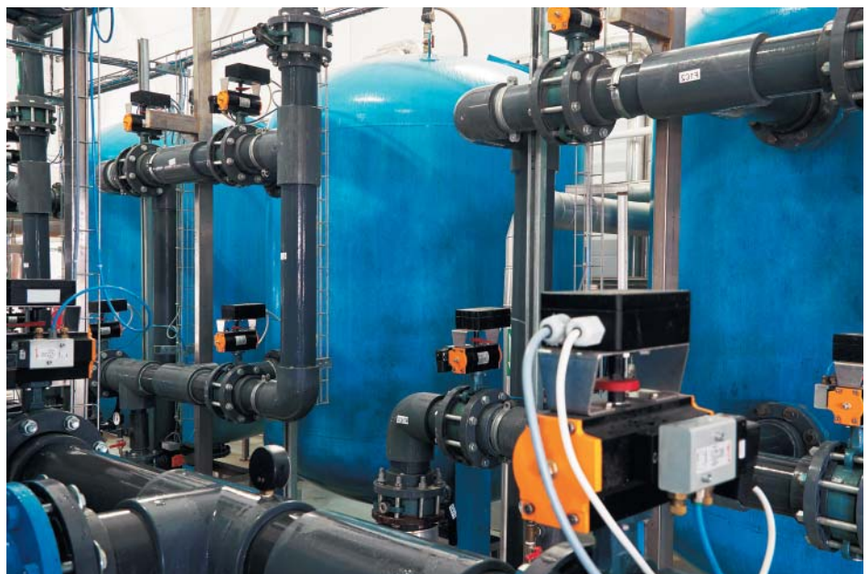
Рис. 1. Технологическое оборудование водоподготовительного комплекса ТЭЦ
