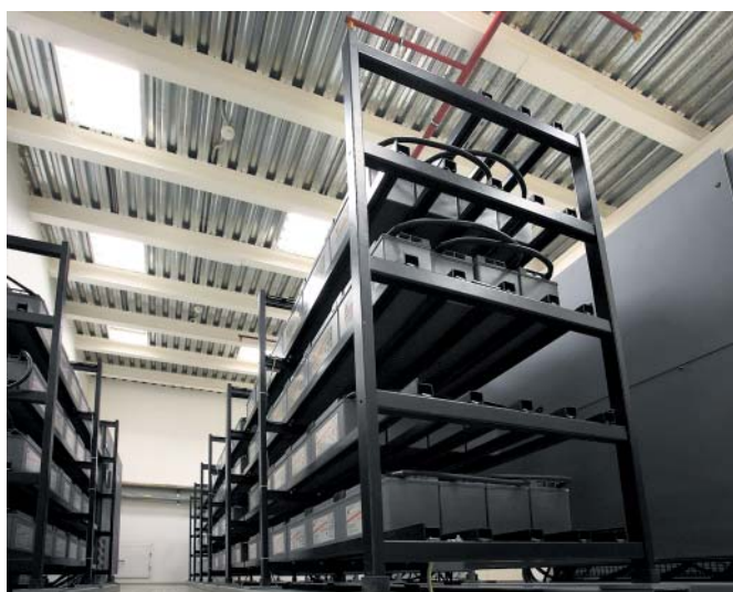
▲ Рабочие помещения. Дата-центр “Траст-Инфо”
